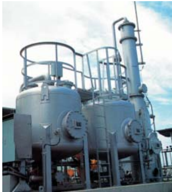
油槽所 近代化システム
