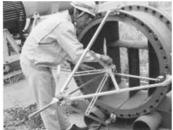
写真3 フランジ歪計測器
